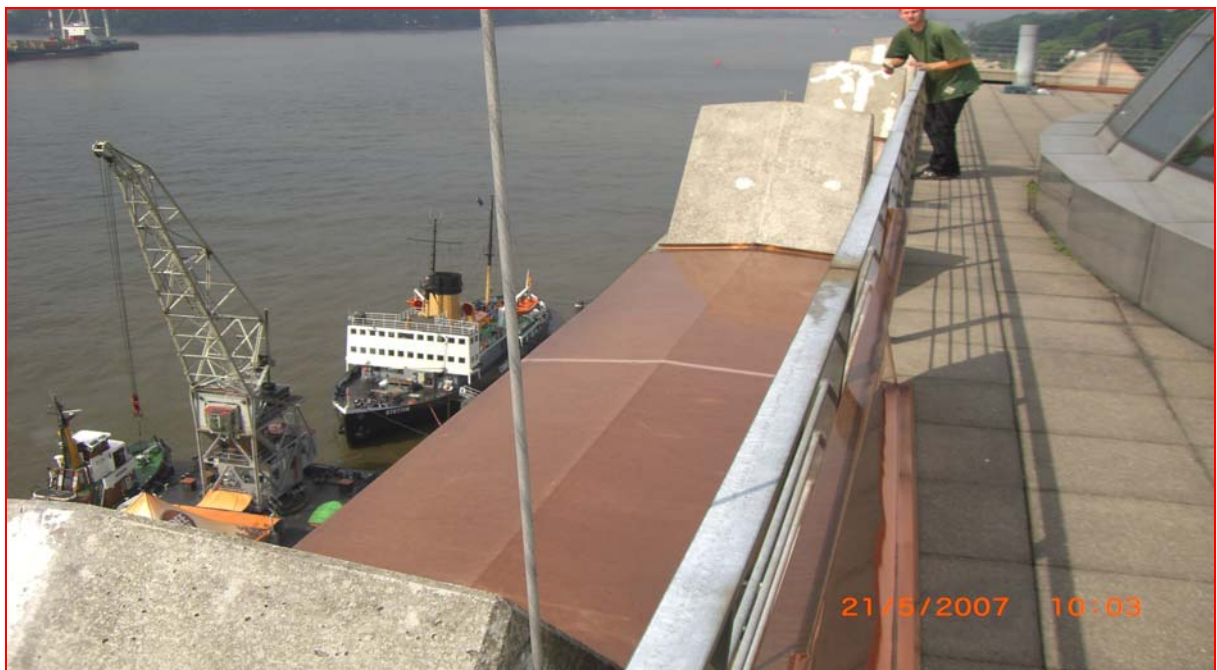
Bild 6: Die Bleche sind fertig verlegt – dank der Enke DS 6 Spritze mit einem gegenüber dem Handauftrag erheblich geringerem Zeitaufwand
