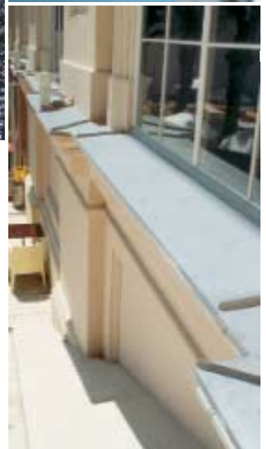
Ein aufwändiges Bauvorhaben: Auch beim MuseumsQuartier Wien wurden die Blechabdeckungen mit ENKOLIT verklebt.
