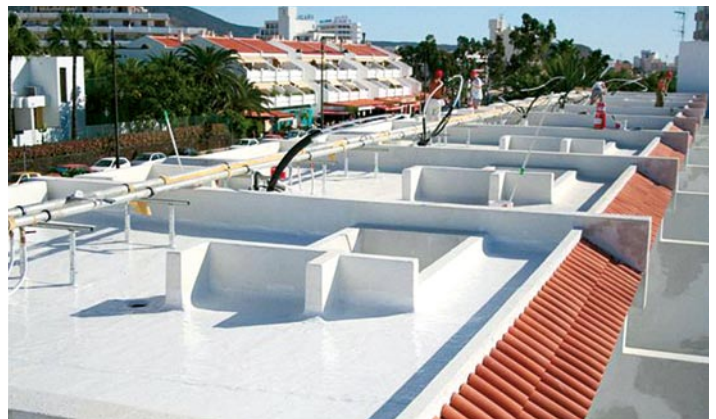
Das weiße Dach reflektiert das Sonnenlicht – die Räume sind deutlich kühler
